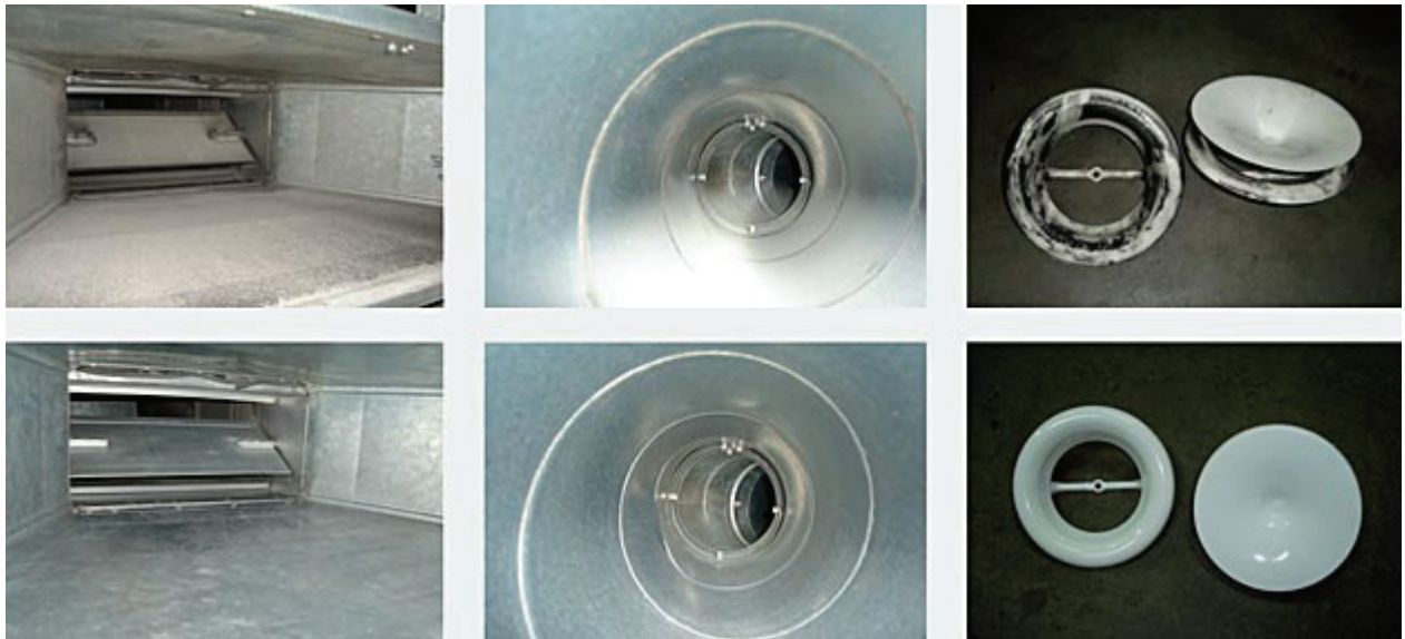
Przykłady elementów instalacji klimatyzacyjno-wentylacyjnej przed i po czyszczeniu
